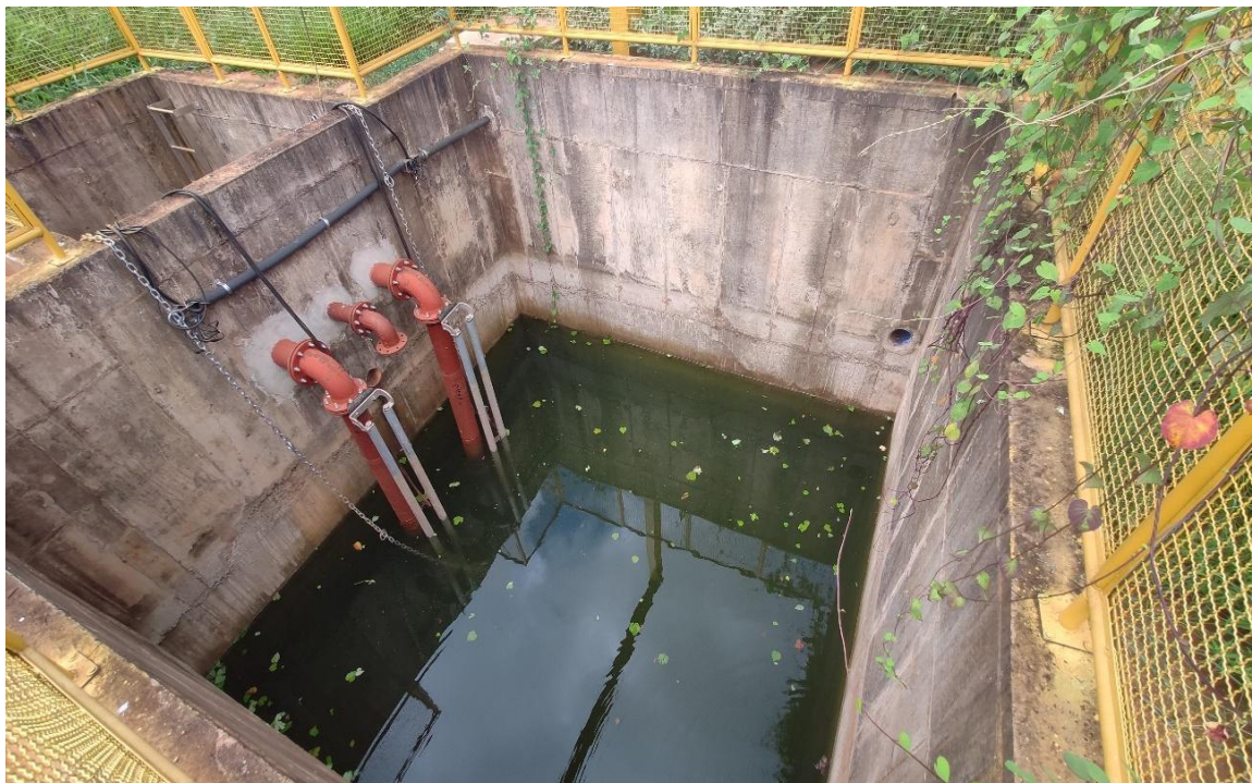
Figura 121: Estação elevatória de recirculação
