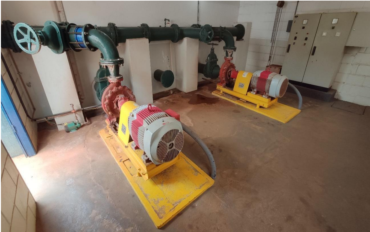
Figura 81: Estação elevatória de água tratada localizada na ETA
