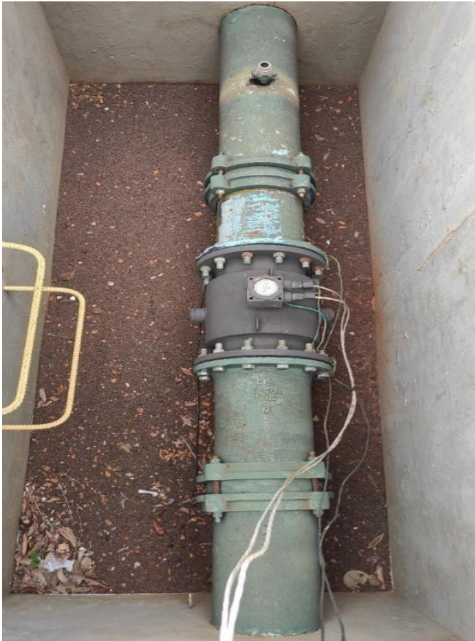
Figura 92: Macromedidor da entrada do centro de reservação
