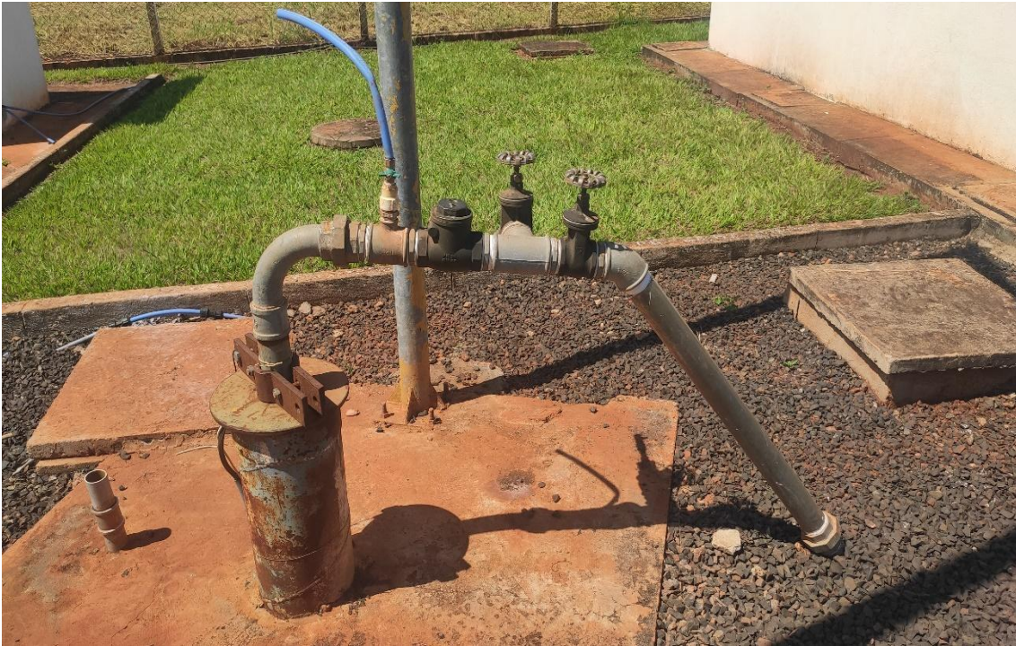
Figura 105: Poço tubular profundo 02
