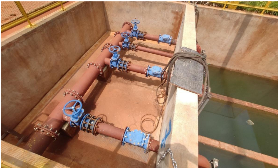
Figura 117: Estação elevatória de esgotos brutos
