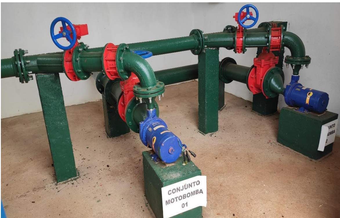
Figura 97: Detalhes internos da estação elevatória de água tratada
