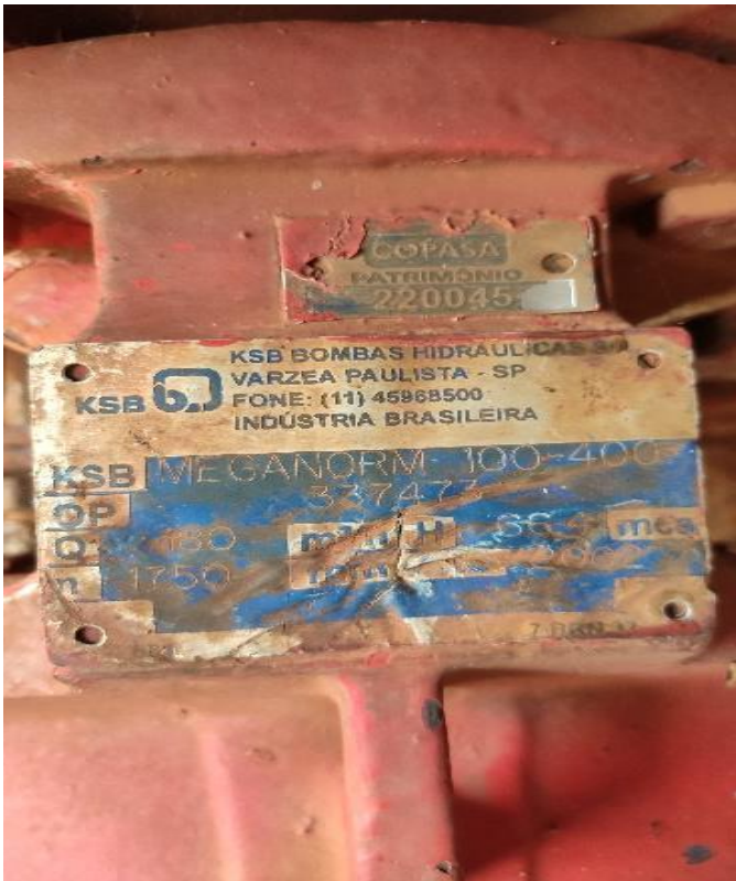
Figura 82: Características do conjunto motobomba esquerdo
