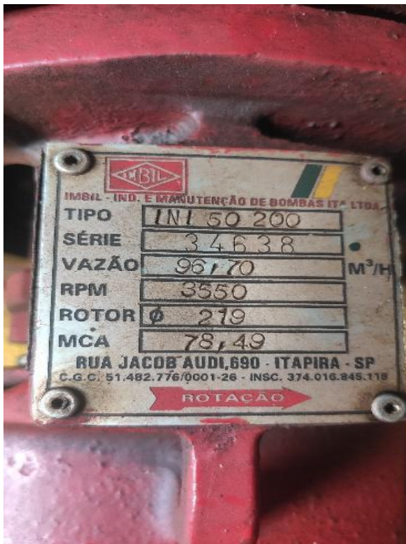
Figura 102: Características do conjunto motobomba esquerdo
