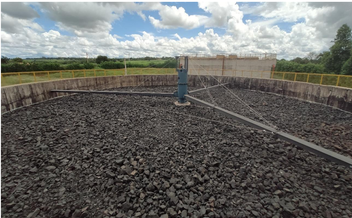
Figura 119: Filtro biológico percolador
