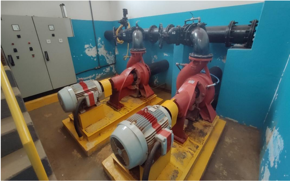
Figura 75: Estação elevatória de água bruta
