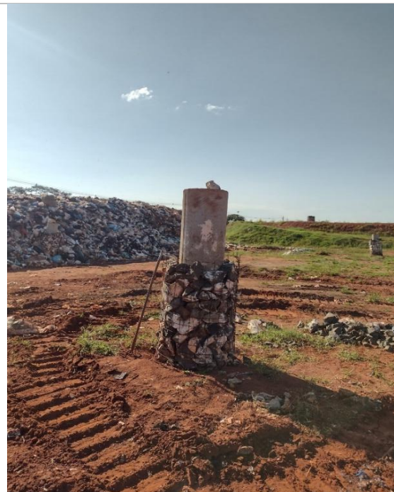
Figura 169: Sistema de coleta e queima de biogás no Aterro Sanitário de Santa Vitória – MG
