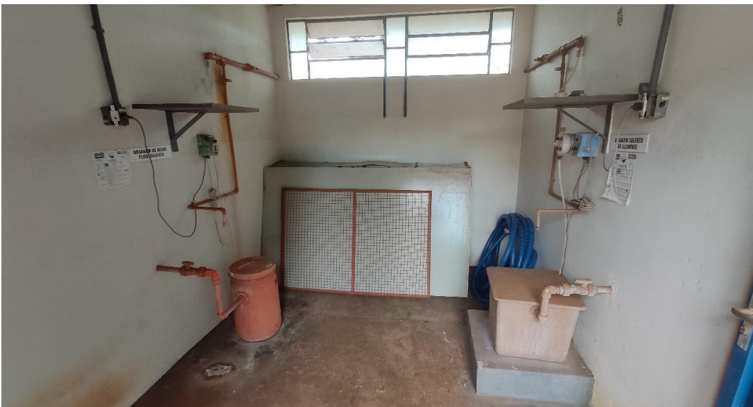
Figura 79: Dosagem de produtos químicos
