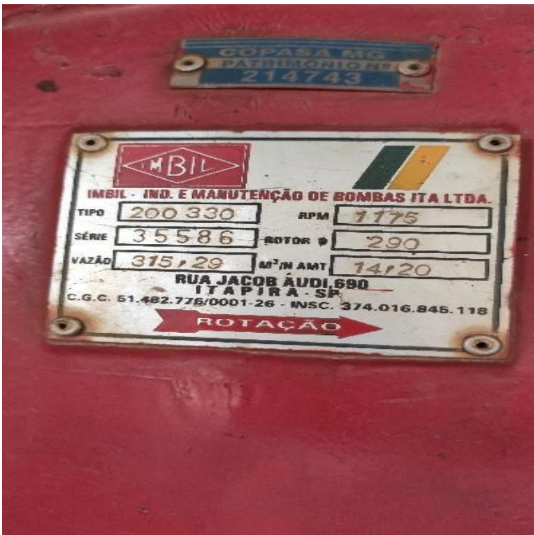
Figura 76: Características do conjunto motobomba esquerdo
