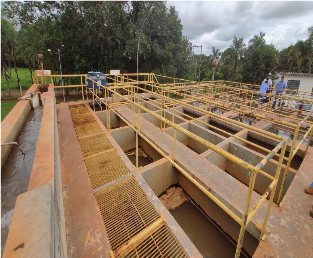
Figura 78: Estação de tratamento de água
