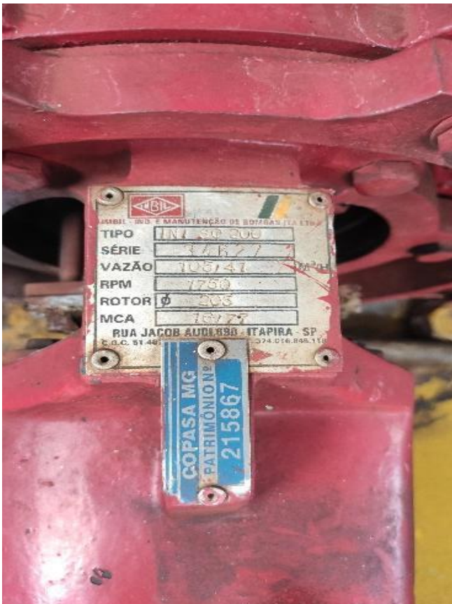
Figura 88: Características do conjunto motobomba mais à esquerda
