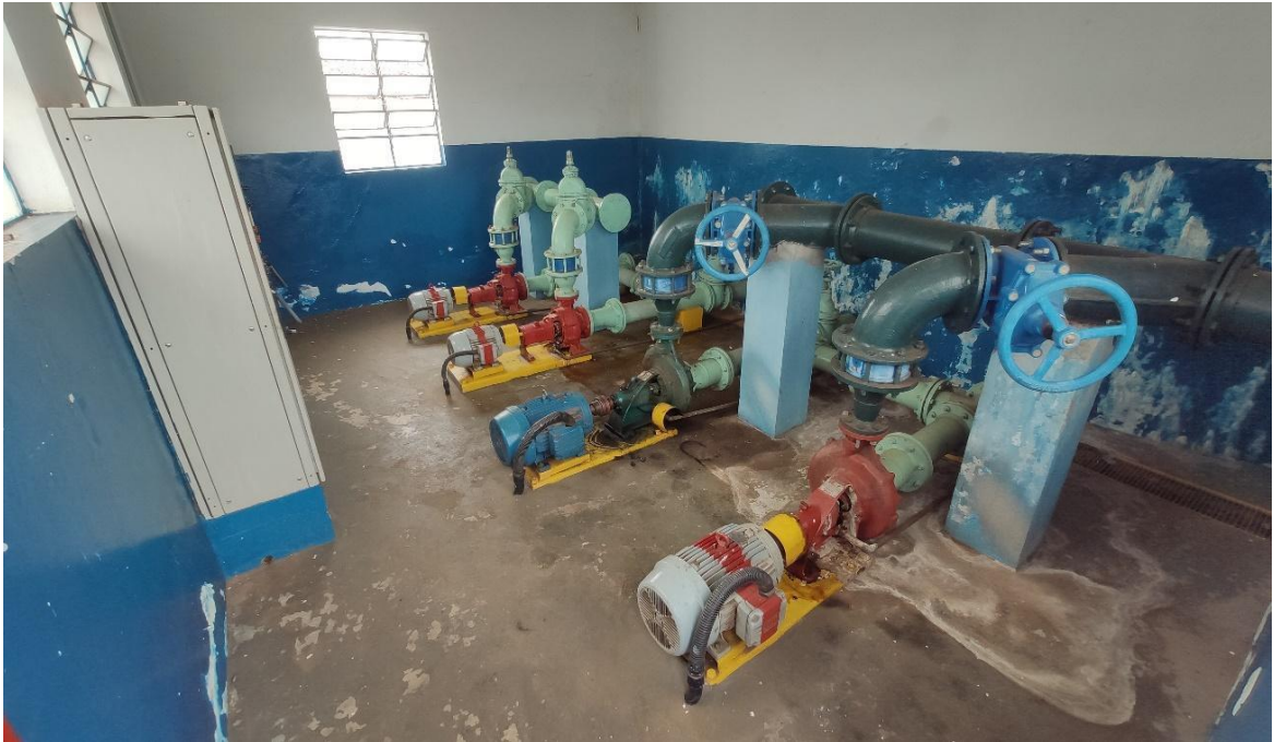
Figura 87: Detalhes internos da estação elevatória de água tratada
