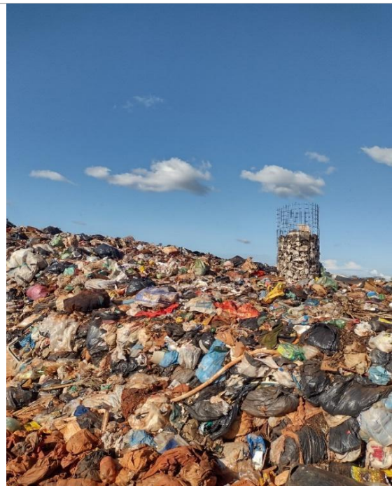
Figura 170: Sistema de coleta e queima de biogás no Aterro Sanitário de Santa Vitória – MG
