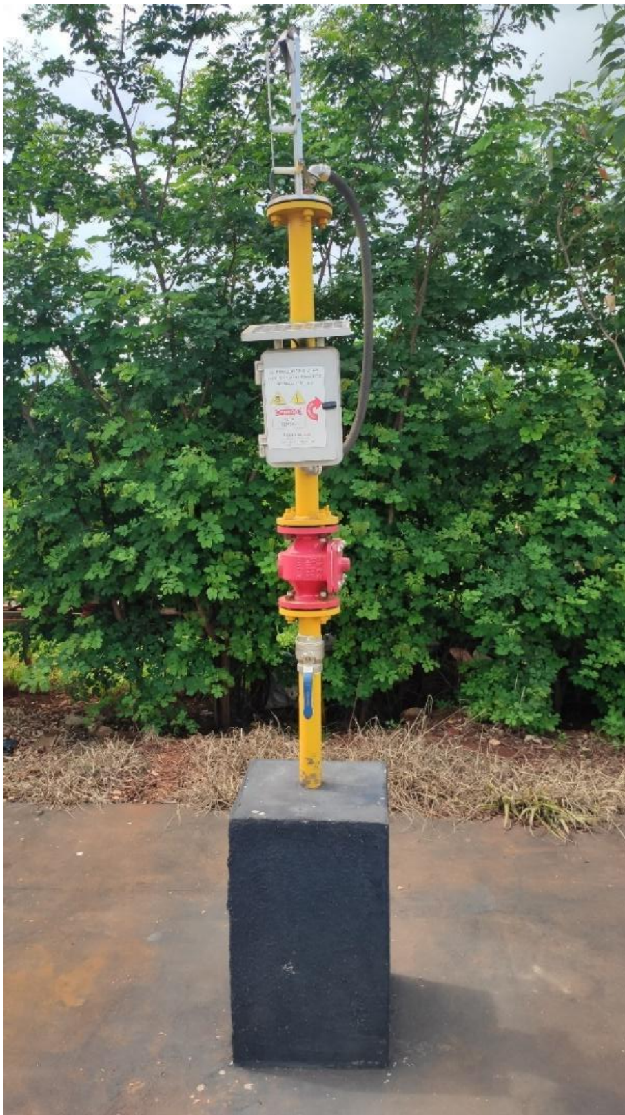
Figura 123: Queimador aberto de gases
