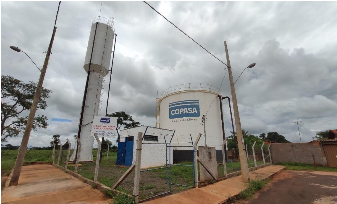
Figura 96: Estação elevatória e reservatórios apoiado e elevado de água tratada
