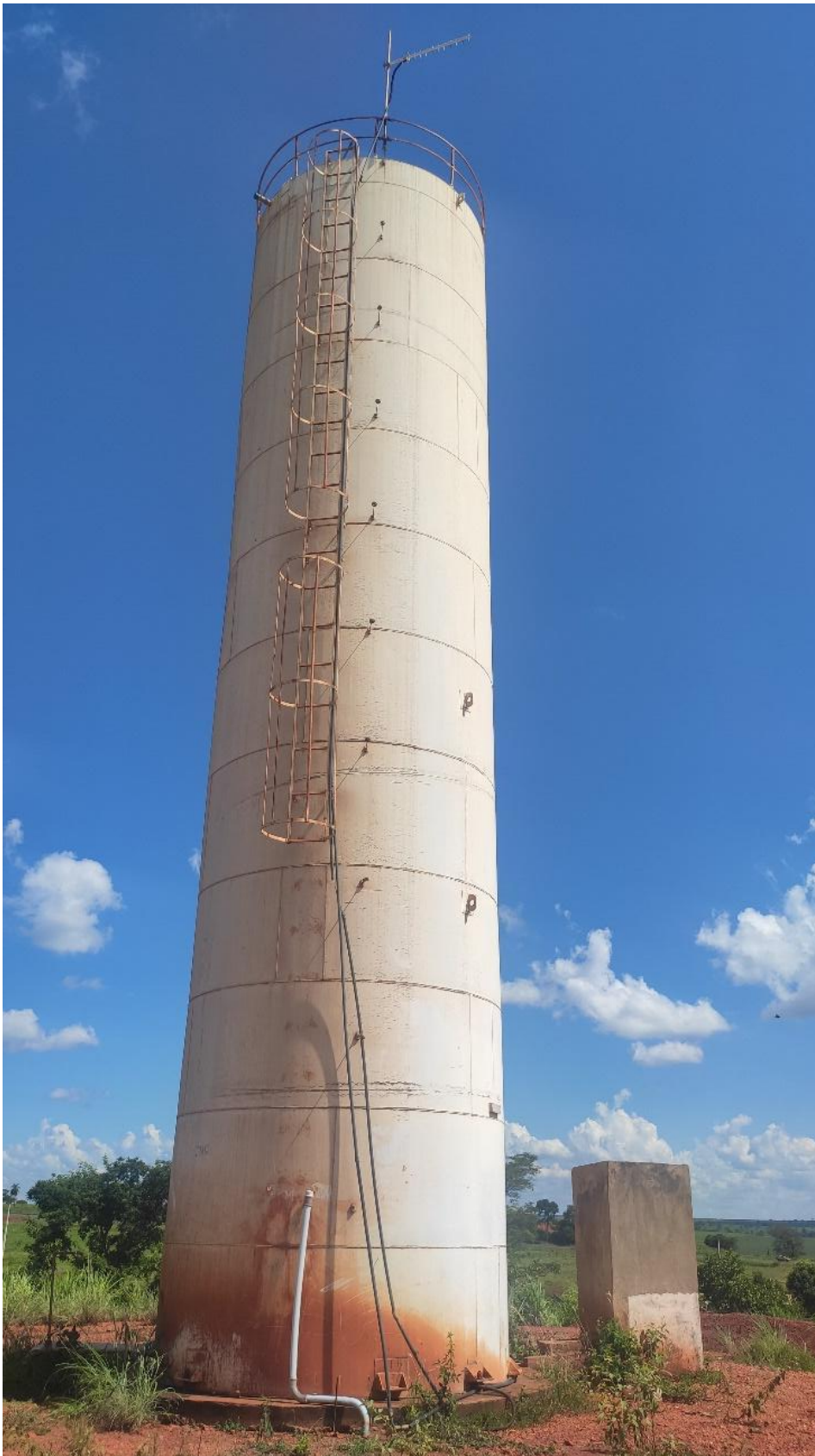
Figura 112: Reservatório apoiado de água tratada
