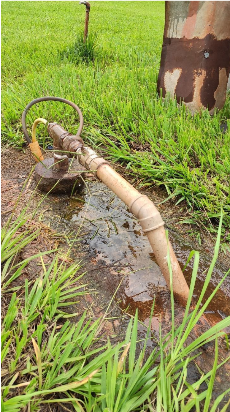
Figura 113: Poço tubular profundo
