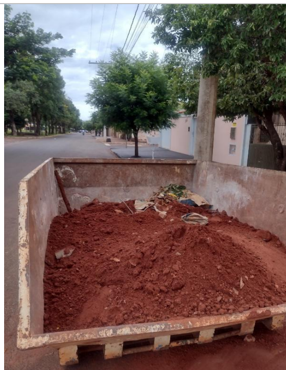
Figura 151: Caçambas localizadas no perímetro urbano de Santa Vitória – MG e destinadas ao acondicionamento de resíduos de construção civil (RCC)
