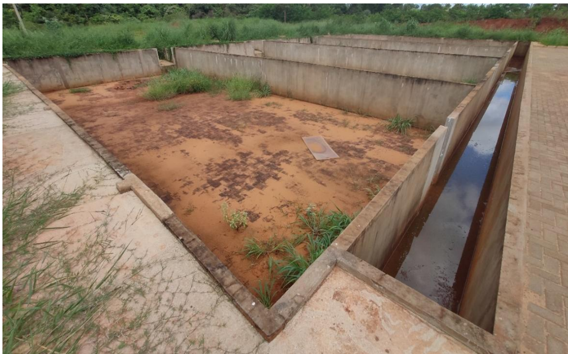
Figura 122: Leitos de secagem
