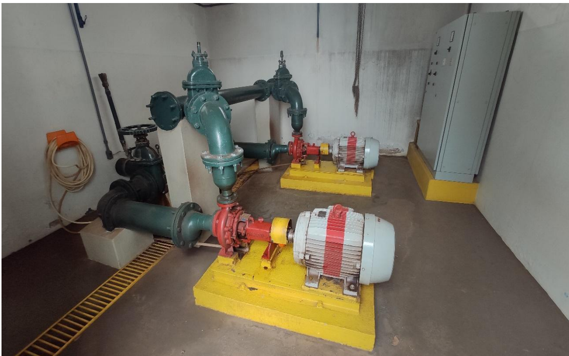
Figura 101: Estação elevatória de água tratada
