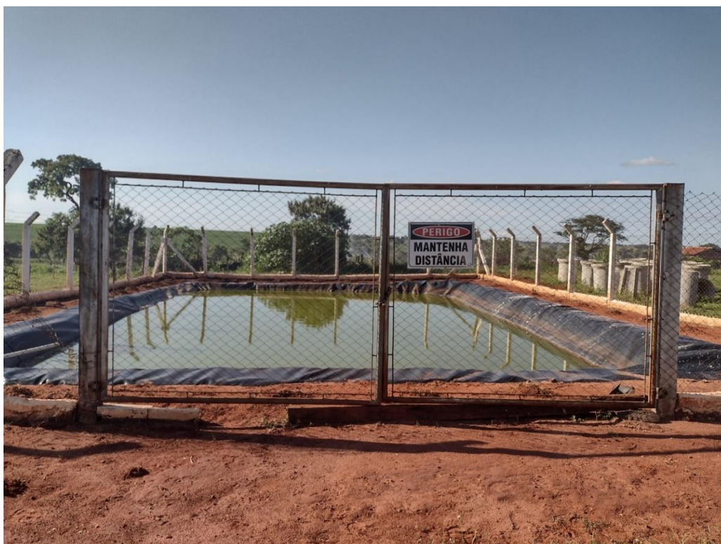
Figura 171: Lagoa de recirculação de lixiviado do Aterro Sanitário de Santa Vitória – MG.
