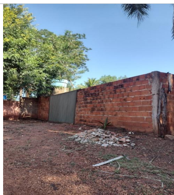
Figura 153: Descarte irregular de RCC no perímetro urbano de Santa Vitória – MG
