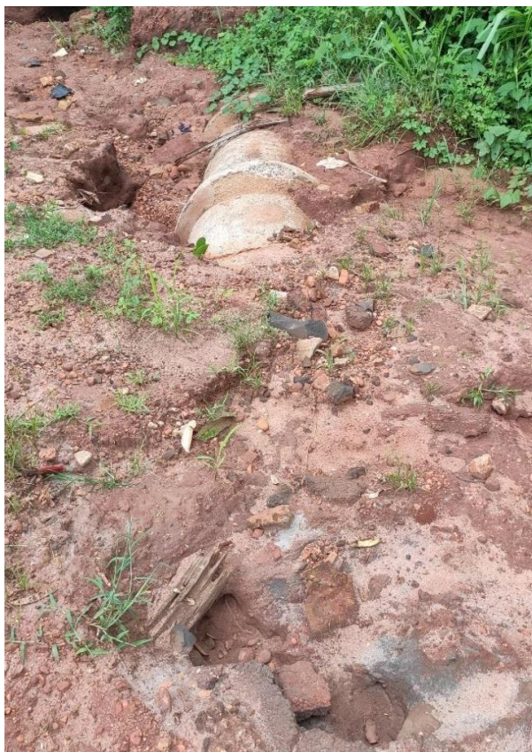
Figura 126: Erosão devido ao escoamento acelerado das águas pluviais
