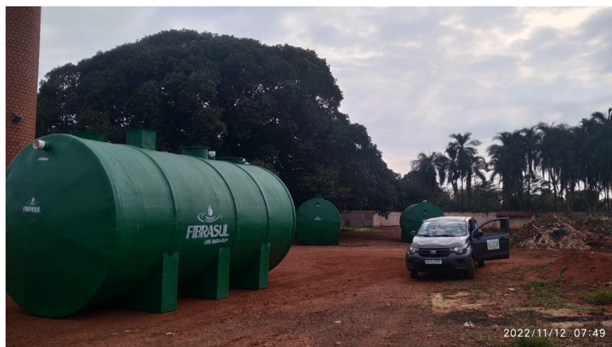
Figura 04: ETE's acondicionadas no distrito de Chaveslândia-MG.
